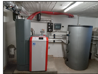
Heizungsanlage, Am Weidenstrauch 5+7 in Lohra
